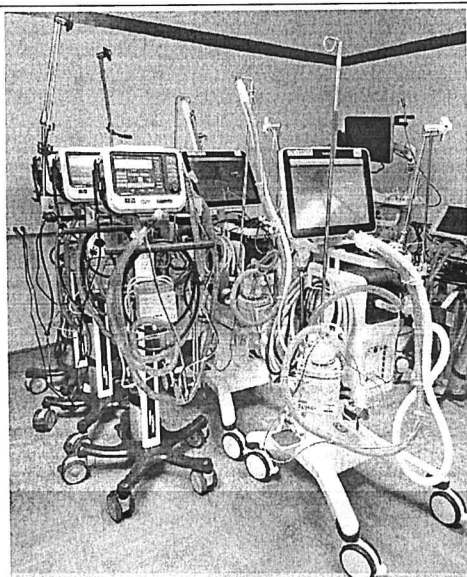
庫房放置備用呼吸器(Servo-u)與 非侵襲性呼吸器(HAMILTON-C1) 並插上電源充電
