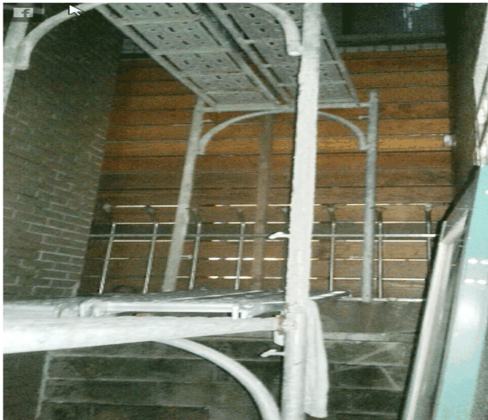
苗栗縣頭份市大同路一處透天厝後方防火巷，下午五點多僱傭3名油漆工人施工時發生慘劇意外。圖／苗栗縣消防局提供
