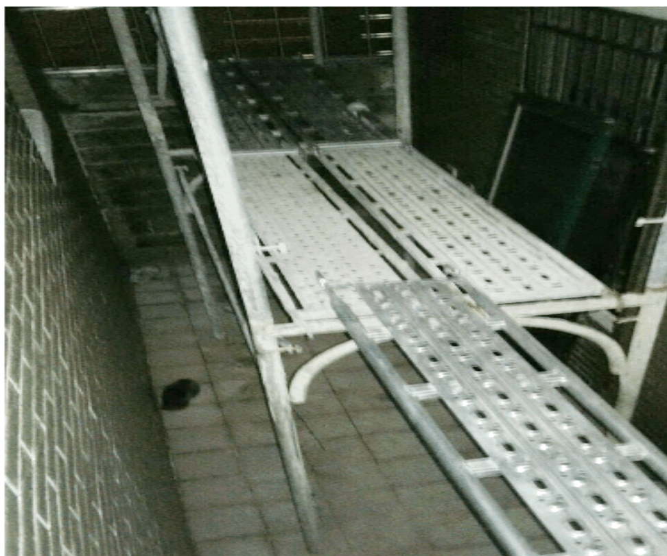
苗栗縣頭份市大同路一處透天厝後方防火巷，下午五點多僱傭3名油漆工人施工時發生慘劇意外。圖／苗栗縣消防局提供
