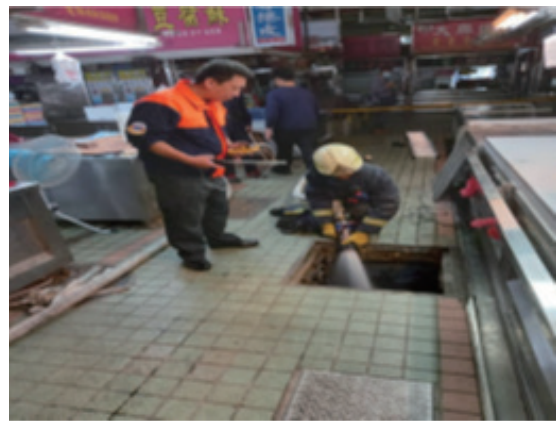
▲ 災害現場未置備測定儀器及通風換氣設備。
